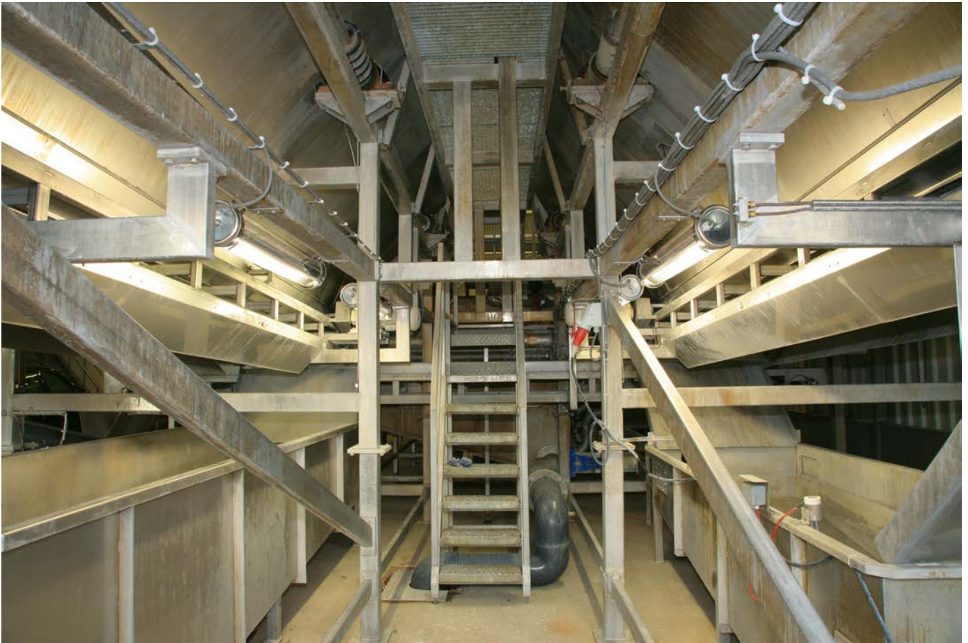
Kläranlage, HAK, Niederlande
