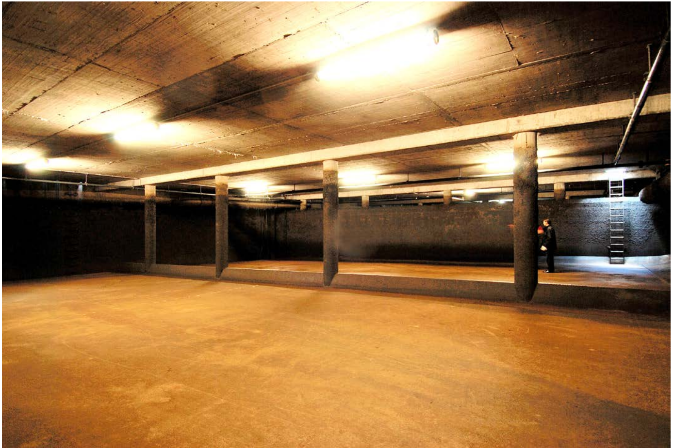
Regenwasserrückgewinnungsbecken, Vlotho, Deutschland
