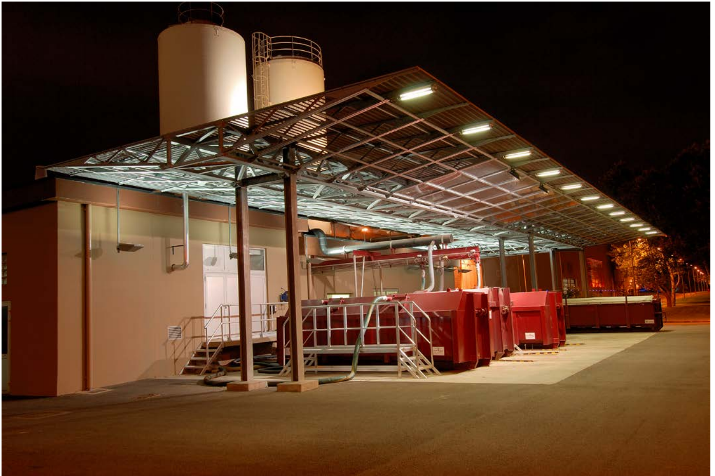
Kläranlage, Ginestous, Frankreich
