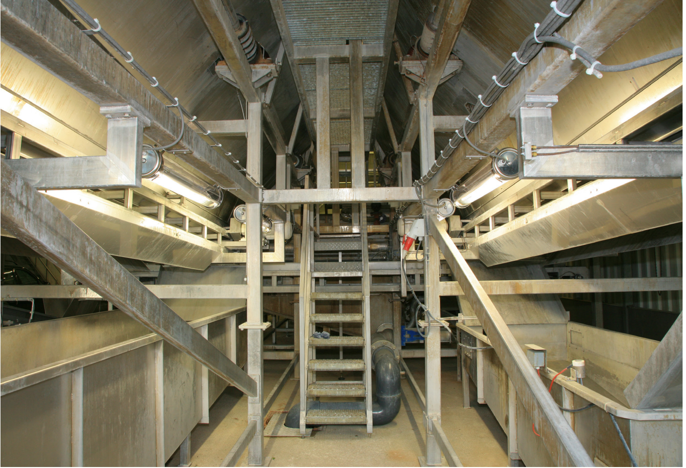
Station d'épuration, HAK, Pays-Bas.
