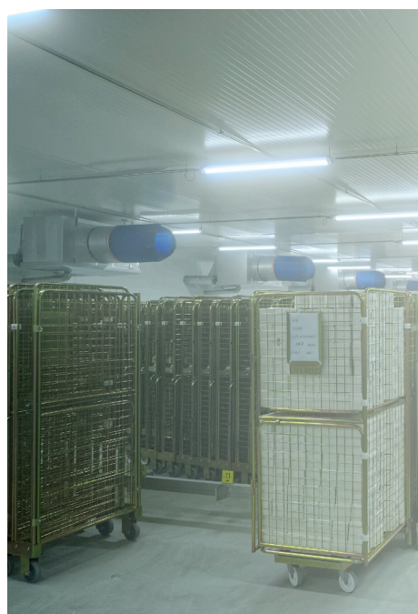
Chambre froide, France
