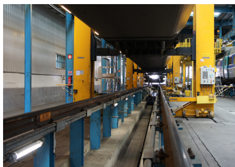
Fosse de maintenance - Niepce FV
