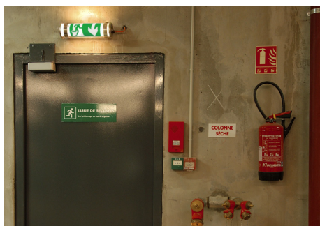
Éclairage de secours - Coulomb BAES
