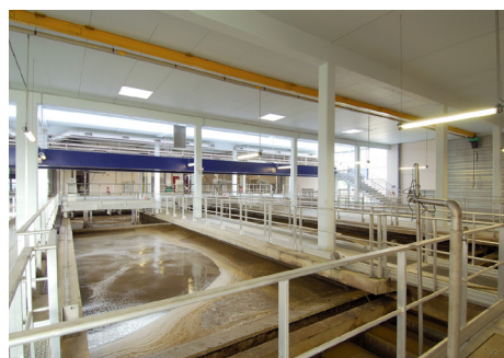
Zone traitement des eaux, France
